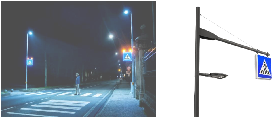
Figura 16 soluzioni di illuminazione dedicata agli attraversamenti pedonali
